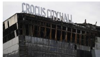
Остатки Крокус Сити Холла на утро после теракта и пожара. Выгорело 13 тысяч м 2 площади
